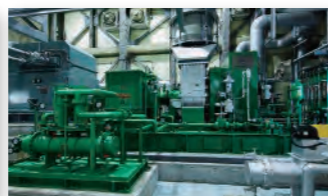
蒸気タービン発電機
