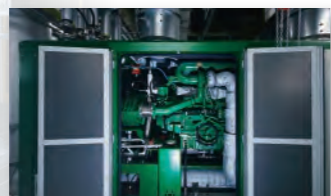
バイオガス発電機
